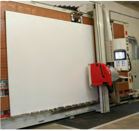
/ Debido a limitaciones espaciales, en LMT solo podía instalarse una solución vertical.
